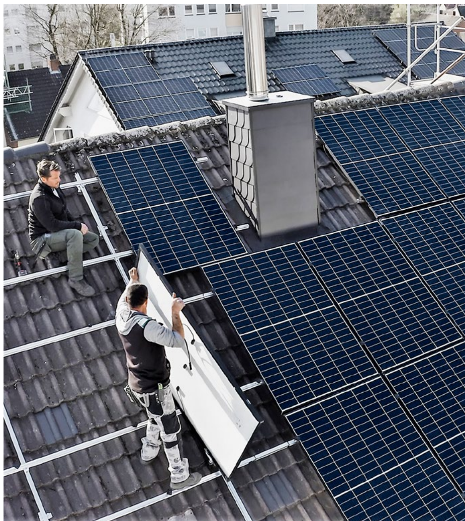
MSP-PR on-roof Ahlen (Allemagne)
