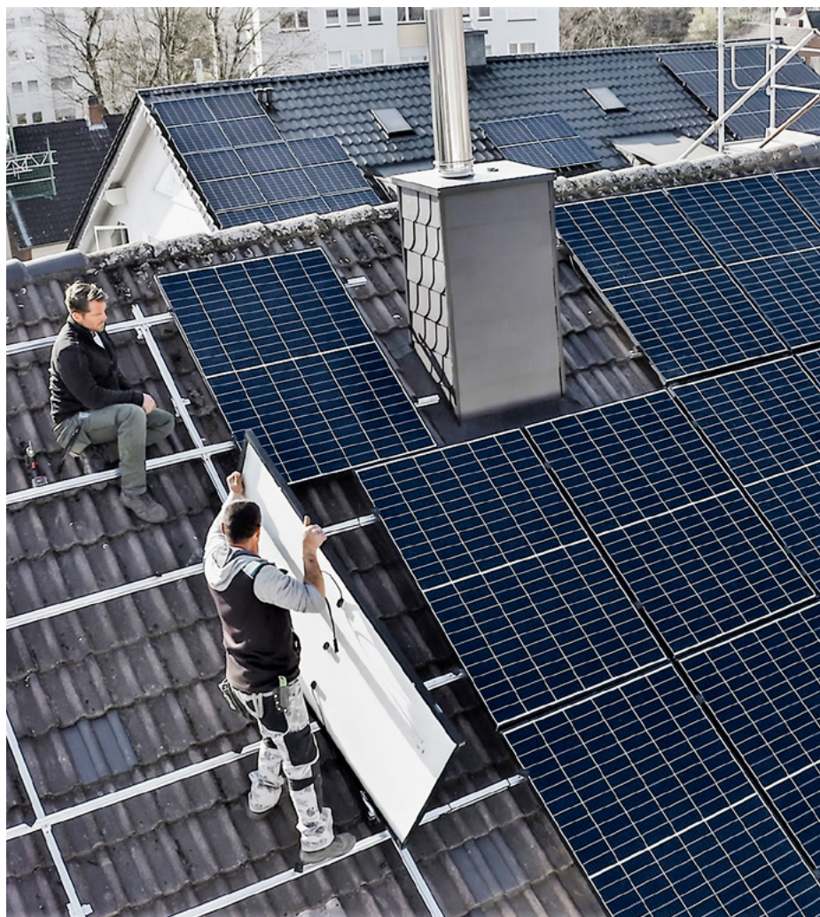
MSP-PR on-roof Ahlen (Allemagne)
